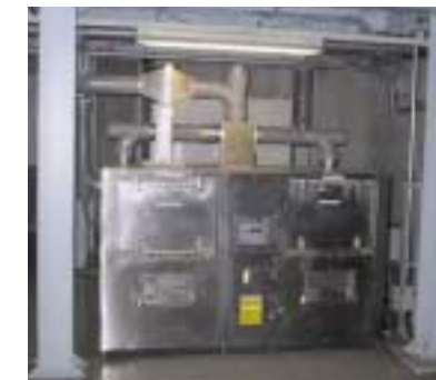
新宿本社ビルの生ゴミ処理機
