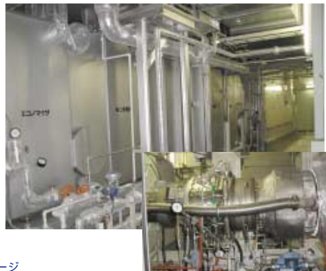
本社新宿ビルのCGS設備
