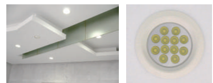
駒込データセンターのLED照明(左右)
