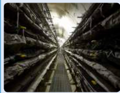
管路 とう道 29万 km 406km
