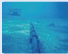
水底ケーブル 800km
