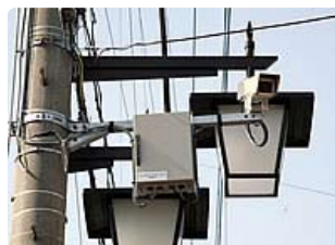
電柱に設置された見守りカメラ
