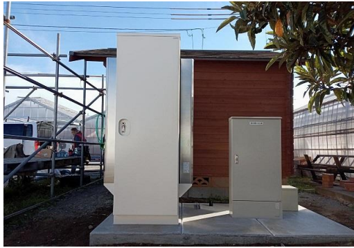
写真3：屋外ラック・分電盤
