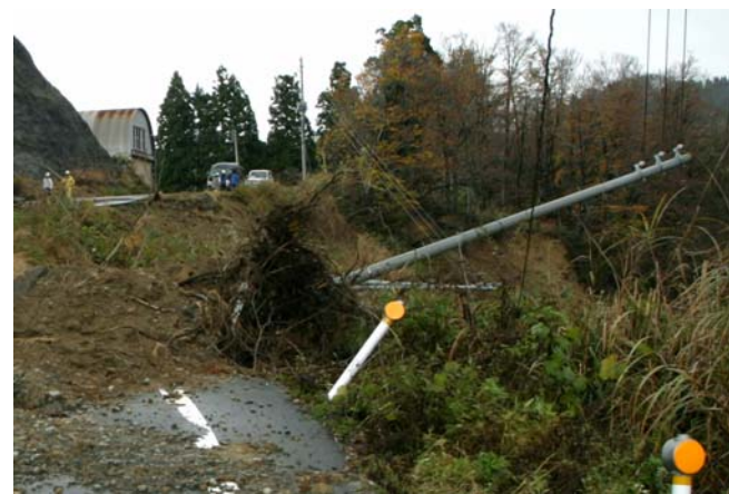
■地震による土砂崩れで被災した電柱・ケーブル
