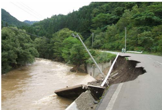
■台風による大雨で被災した電柱・ケーブル
