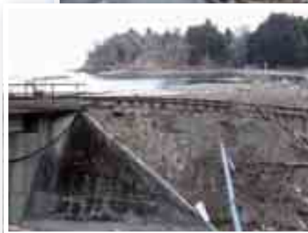
三陸鉄道の線路とともに中継伝送路が流出・切断 (岩手県大船渡市)
