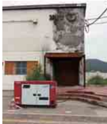
大楯ビルに設置された非常用発電機 (岩手県大楯町)
