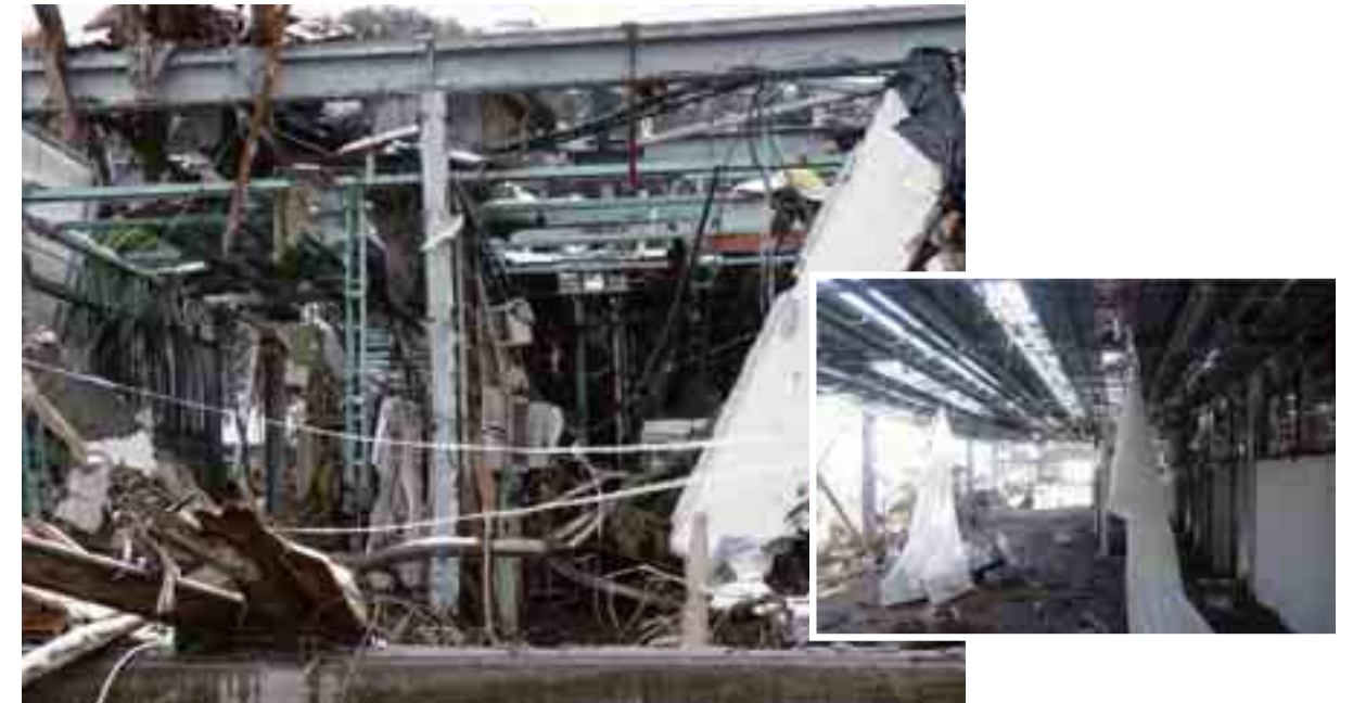
壁が崩壊し内部にも大量の漂流物
