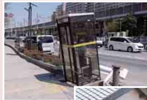
液状化によって傾倒した 公衆電話 (千葉県浦安市)
