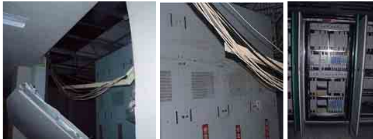
1階の電力設備が大きく損傷
