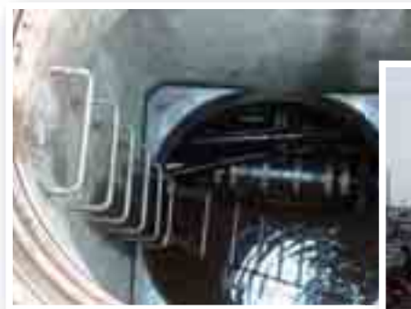
水が溜まったマンホール (岩手県大船渡市)
