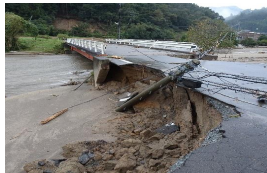
台風19号の被害
