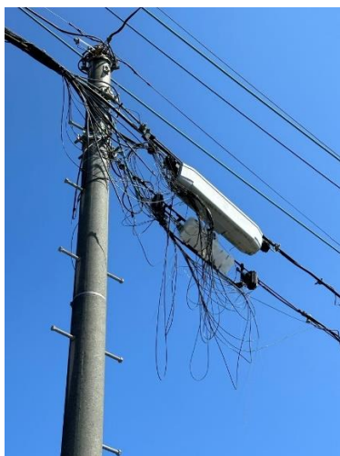
クロージャ蓋破損
