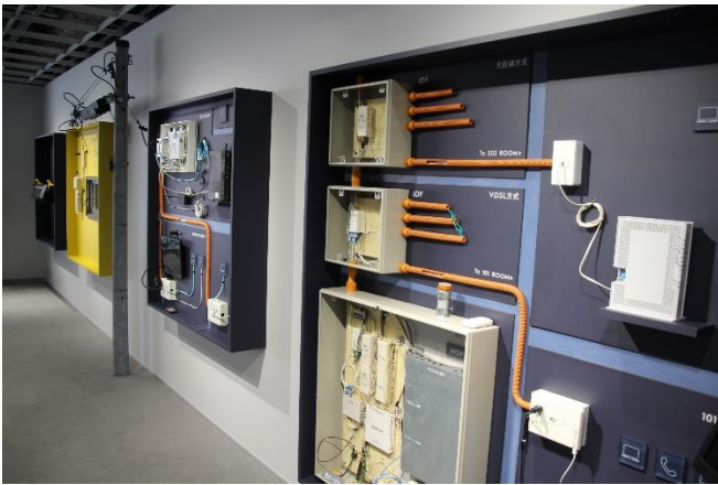
屋外・宅内配線設備の展示
