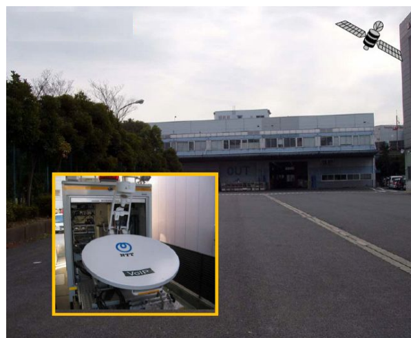
〔ひかり電話の故障演習における代替回線の開通〕
