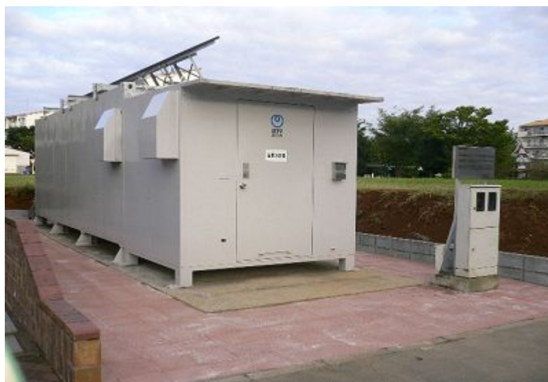
[CPリサイクル舗装とアットシールドカラー塗装が施されたRT-BOX]
