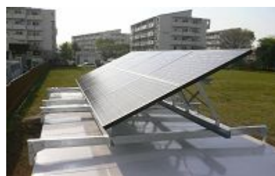
[太陽光発電システム]
