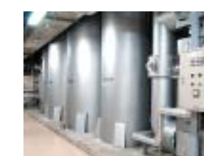
コージェネレーションシステム
