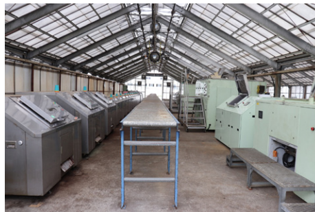
給食残渣を堆肥化する設備
