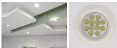
駒込データセンターのLED照明(左、右)
