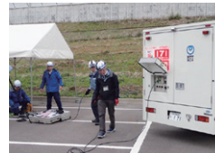
移動電源車による給電
