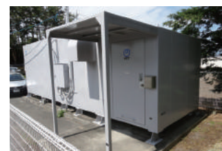
屋外通信設備の一例
