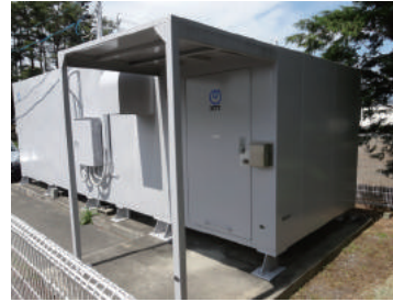
屋外通信設備の一例
