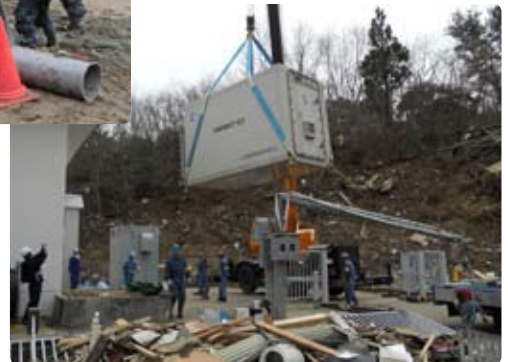
可搬形RT-BOXの設置
