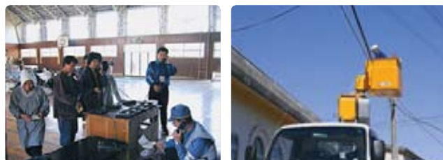
避難所での特設公衆電話の設置
