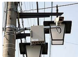
電柱に設置された見守りカメラ
