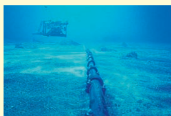
水底ケーブル 800km
