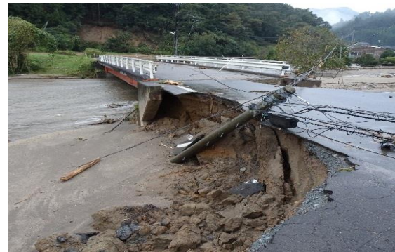
台風19号の被害
