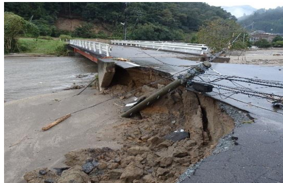
台風19号の被害
